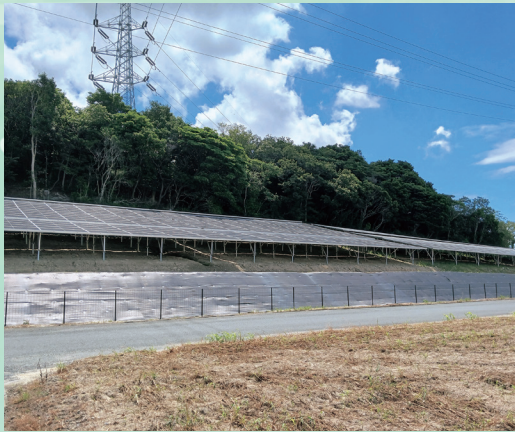
2025年7月 福祉村太陽光発電所開所
